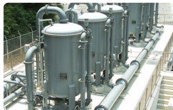
高速繊維ろ過装置
